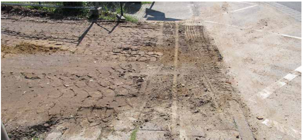
Das lose Material stellt für Fußgänger eine Unfallgefahr dar.
