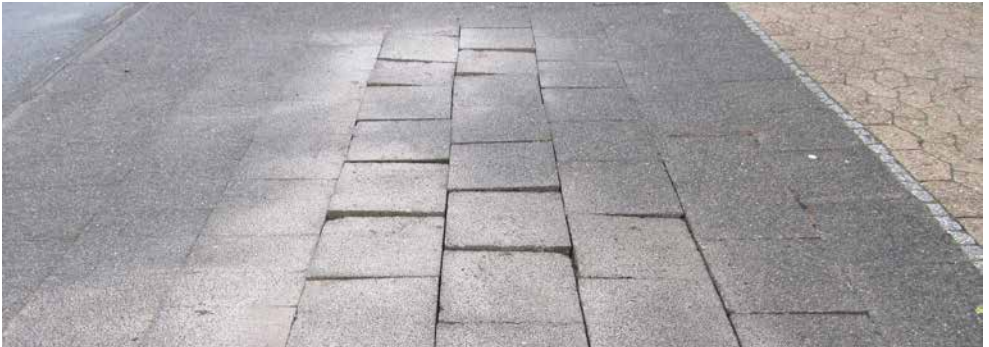
Die Platten wackeln und stellen eine Unfallgefahr dar.
