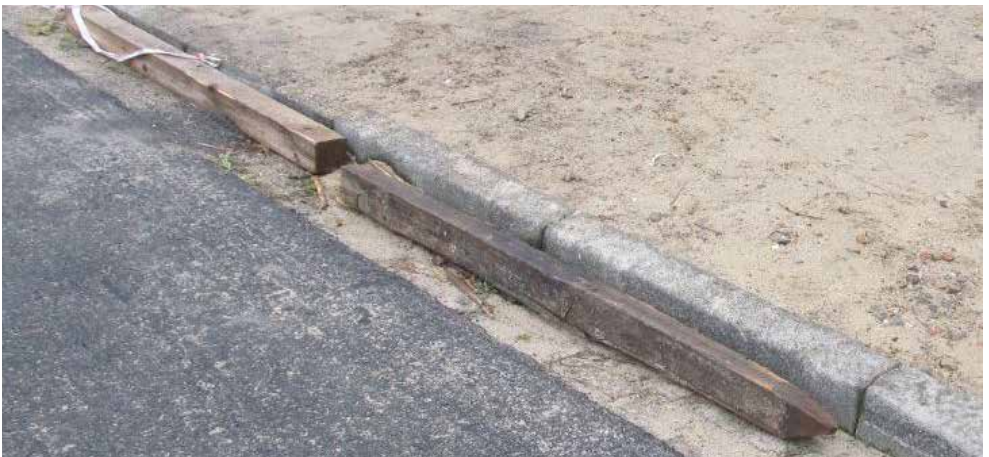
Hindernisse in der Gasse stellen eine Unfallgefahr für Fahrzeuge und Radfahrer dar, außerdem behindern sie den Wasserabfluss in der Gasse.
