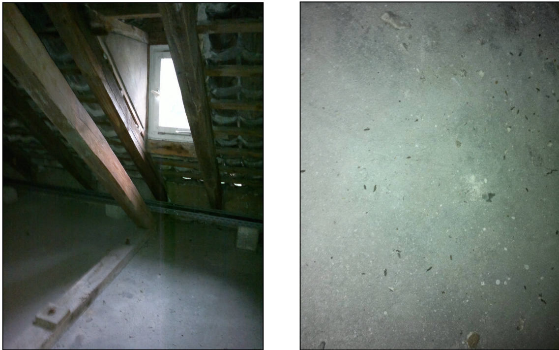
Abb. 3: Dachstuhl des Gebäudes D mit Fledermauskot.
